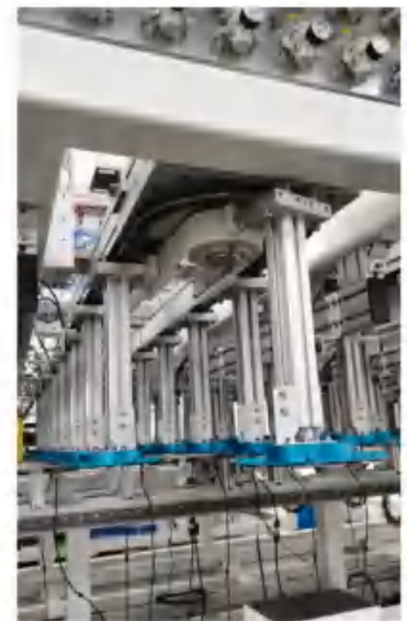
2 吊装五金喷涂自动化流水线
